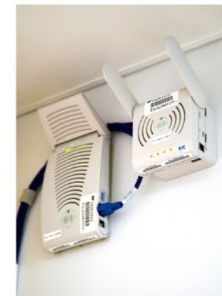
壁面に設置されたアクセスポイント (左:Aruba61 右:aruba65)
